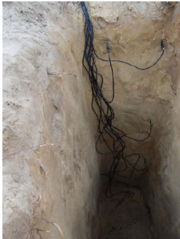
Sensores instalados en el punto de Los Sotos.
