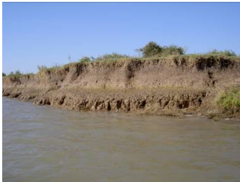
Figura 1.- Escarpe erosivo en la margen del Guadalquivir afectando a la Montaña del Río.
